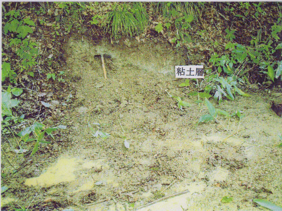
図-4-21 ⑦の地すべり土塊中の粘土層と道路面上の水溜まり
