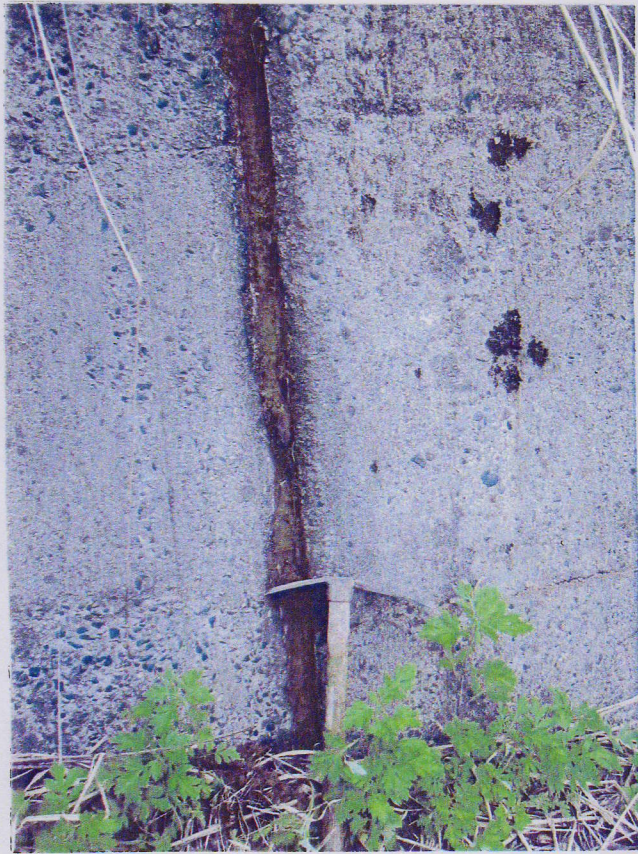
図-4-17 ⑥の地すべりのAの領域内の道路擁壁に見られる亀裂
